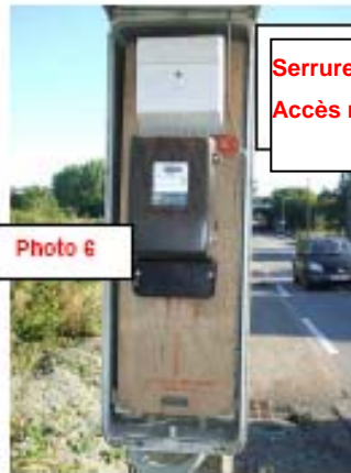
Coffret sur poteau, ouvert
