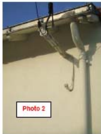
Câble de branchement, vu de près
