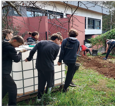
Alimentation durable de la mare en eau de pluie via le récupérateur connecté à la gouttière du bâtiment G.
